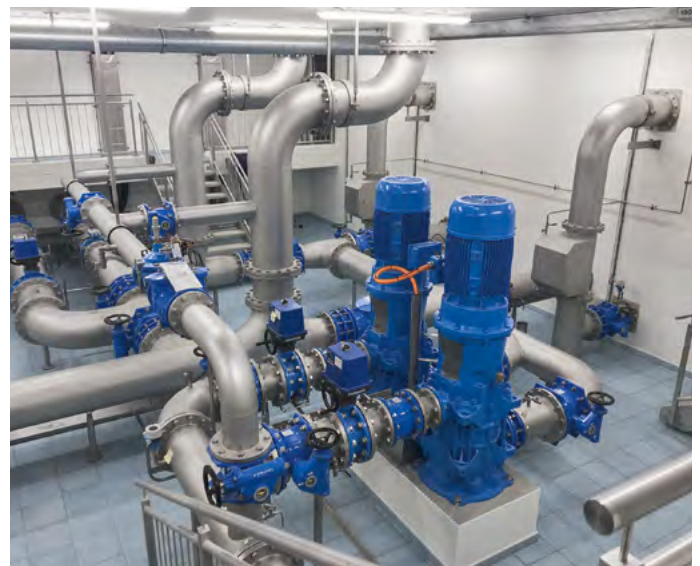
Pumpenaggregate mit den von Hagenbucher gelieferten Düsenrückschlagventilen.
