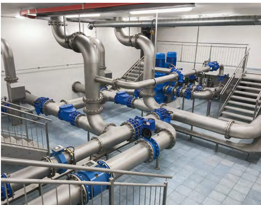
Rohrkeller im neuen Reservoir Gönhard.
